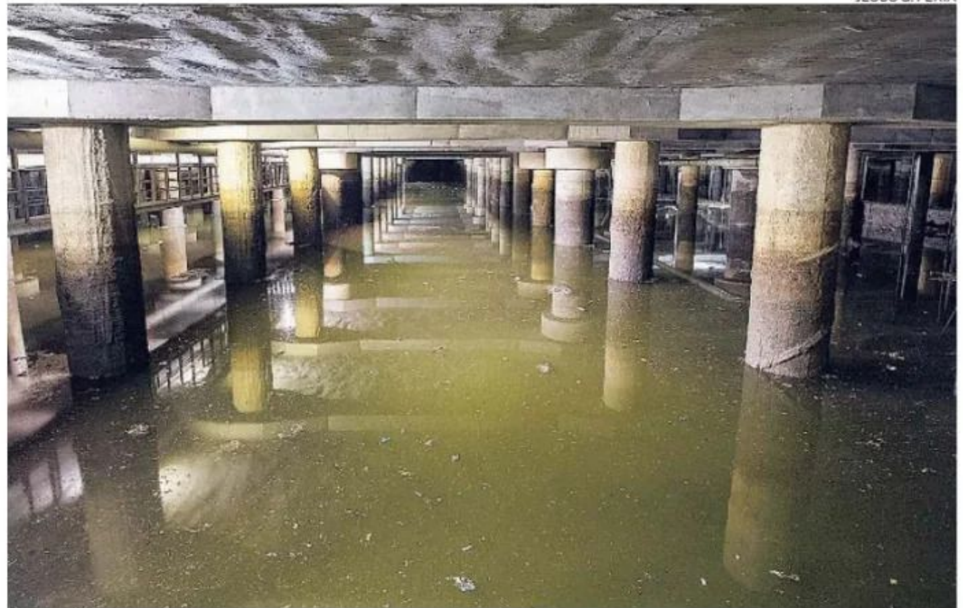
Imagen del tanque de tormentas de Arroyofresno
